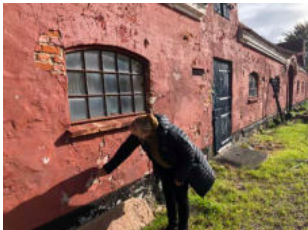
Annebjerggård i Nykøbing, tegnet af arkitekten Einar Andersen i 1923. Bygningen er desværre blevet malet med akrylmaling, og derfor er der sket skader på bygningen
