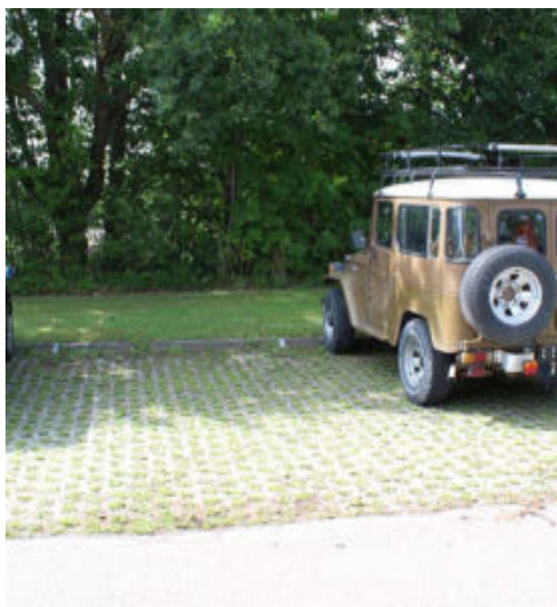
Rådhuset i Højby har permeable belægning til parkeringspladser, som gør det nemmere for vandet til at sive ned og samtidig gør det gaden mere grøn
